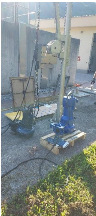
Slika 10: okvara in zamenjava črpalke septika
